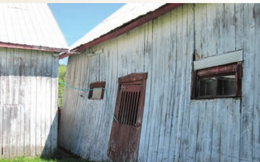
Charpente légère qui s'est déformée avec le temps.
