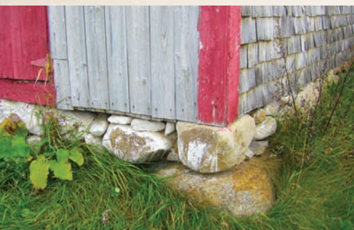
Fondations en pierres sèches exposées au gel.
