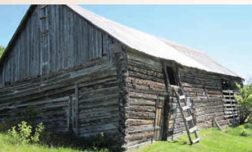
Mur en pièce sur pièce dont la base pourrie crée un affaissement.
